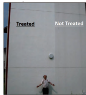
外壁の汚れの違い
