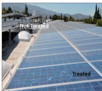
太陽光パネルの汚れの違い
