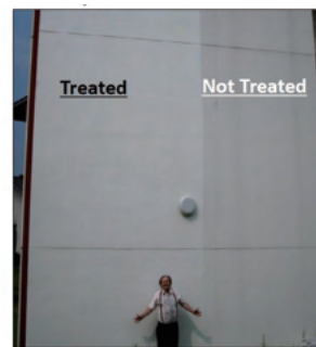
外壁の汚れの違い
